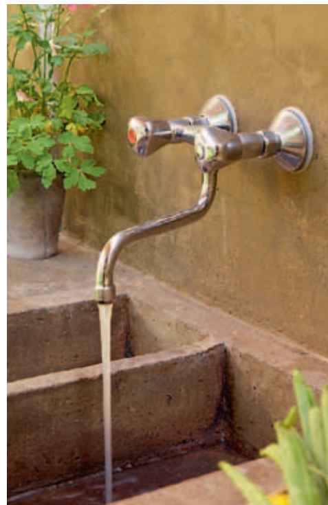
Rått og integrert. Rør og armaturer er integrert i primærkonstruksjonen, altså betongen. Det røffe uttrykket samsvarer med følelsen av å være på et utekjøkken. Fraværet av utføring bidrar også til å spare verdifull plass.
